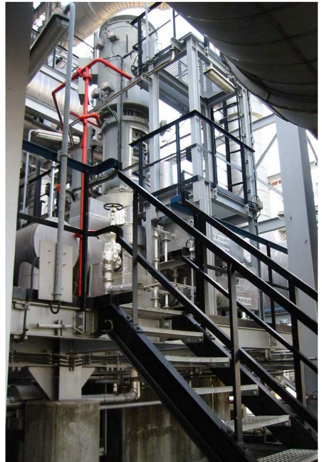
Figure 3: LNG Expander at the LNG plant in Malaysia
