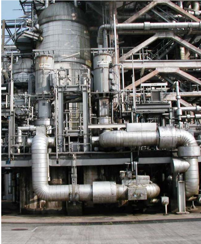
Figure 4: LNG and MR Expanders at an LNG Plant in Nigeria
